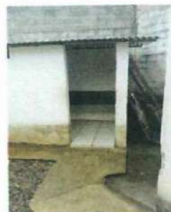
Foto 6: Los mingitorios necesita su privacidad y es necesario la colocación de puerta de mental en cada uno de los dos mingitorios que posee el establecimeinto.
