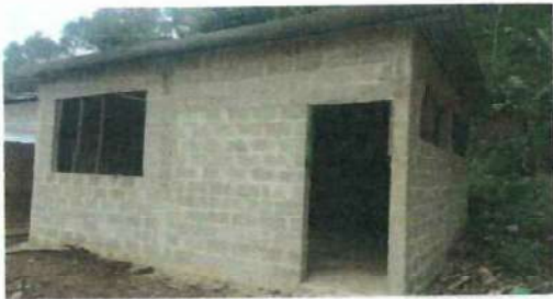
Foto1: Cocina necesita su acabado en paredes interiores y exteriores, instalación de puerta y sus respectivas ventanas con balcón .
