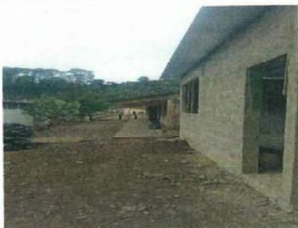
Foto 3: Es necesaria la estructura de techo y la colocación de laminas en el corredor frente a la cocina para poder transportar alimentos a las aulas sin mojarlos a la vez es importante el piso de concreto para evitar el lodo.
