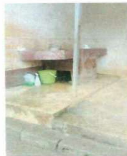
Foto 4: La pila de concreto por su uso se esta deteriorando, por lo que es necesarios cubrirla de azulejo para alargar su vida útil, de igual forma es necesario colocar piso antideslizante en el espacio en que se encuentra.
